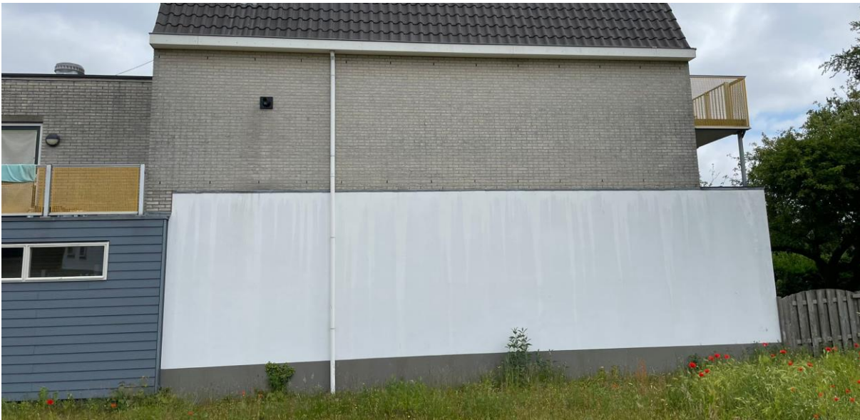
Figuur 6 - De open stootvoegen in het pand naast het plangebied.
